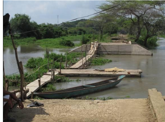
Fotografía 8. Afectación de infraestructuras viales, puente entre San Estanislao de Kostka y Soplaviento (Bolívar).
