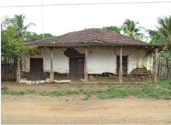
Fotografía 5. Vivienda afectada en Mahates (Bolívar).
