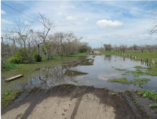
Fotografía 7. Afectación de infraestructuras viales, vía en Santa Lucía (Atlántico).
